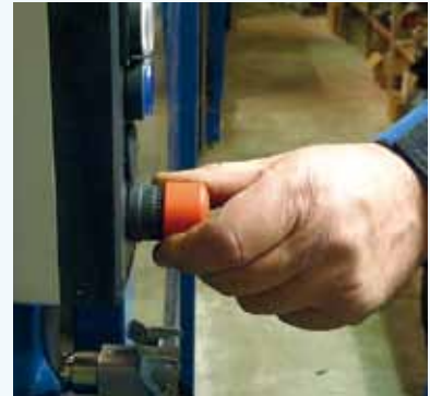
Ein Not-Aus-Schalter schützt Techniker und Anlage bei Notfällen
