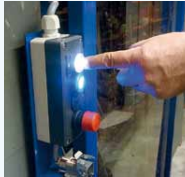
Das Hauptbedienelement zum kontrolliertem Eingreifen bei Störungen
